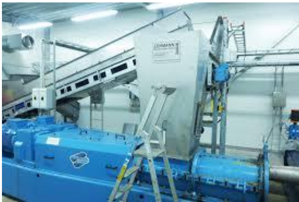
Figur 5. Bioextruder från Lehmann GmbH vid Karlskoga Biogas. Foto: Sven-Erik Svensson
